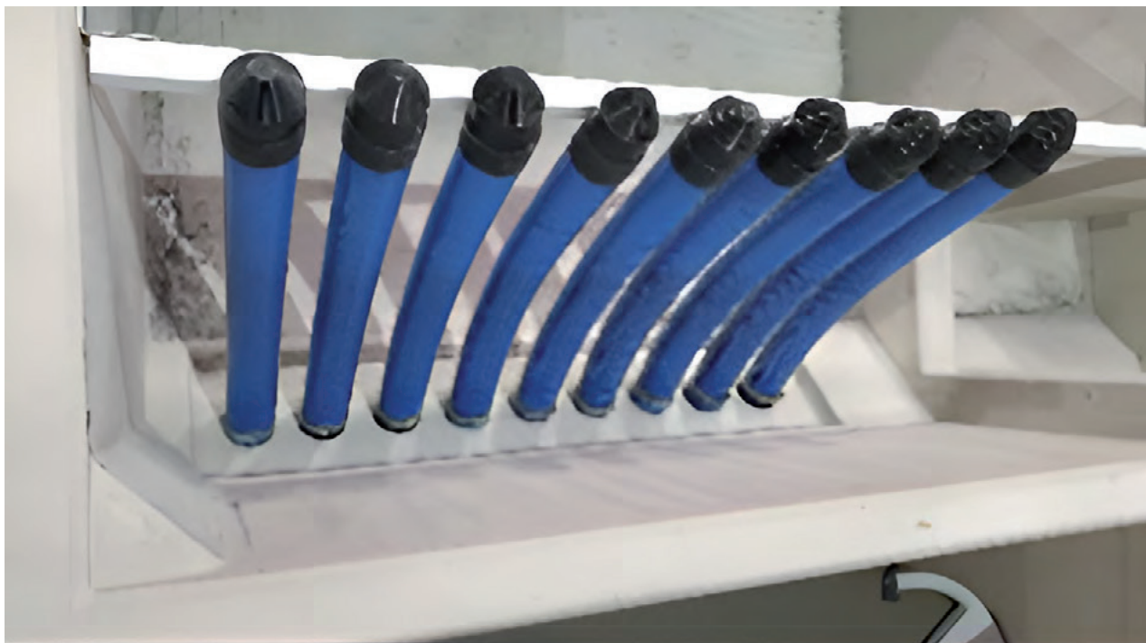
↓ Afbeelding 6. ingestorte slangtules in compactstation.
