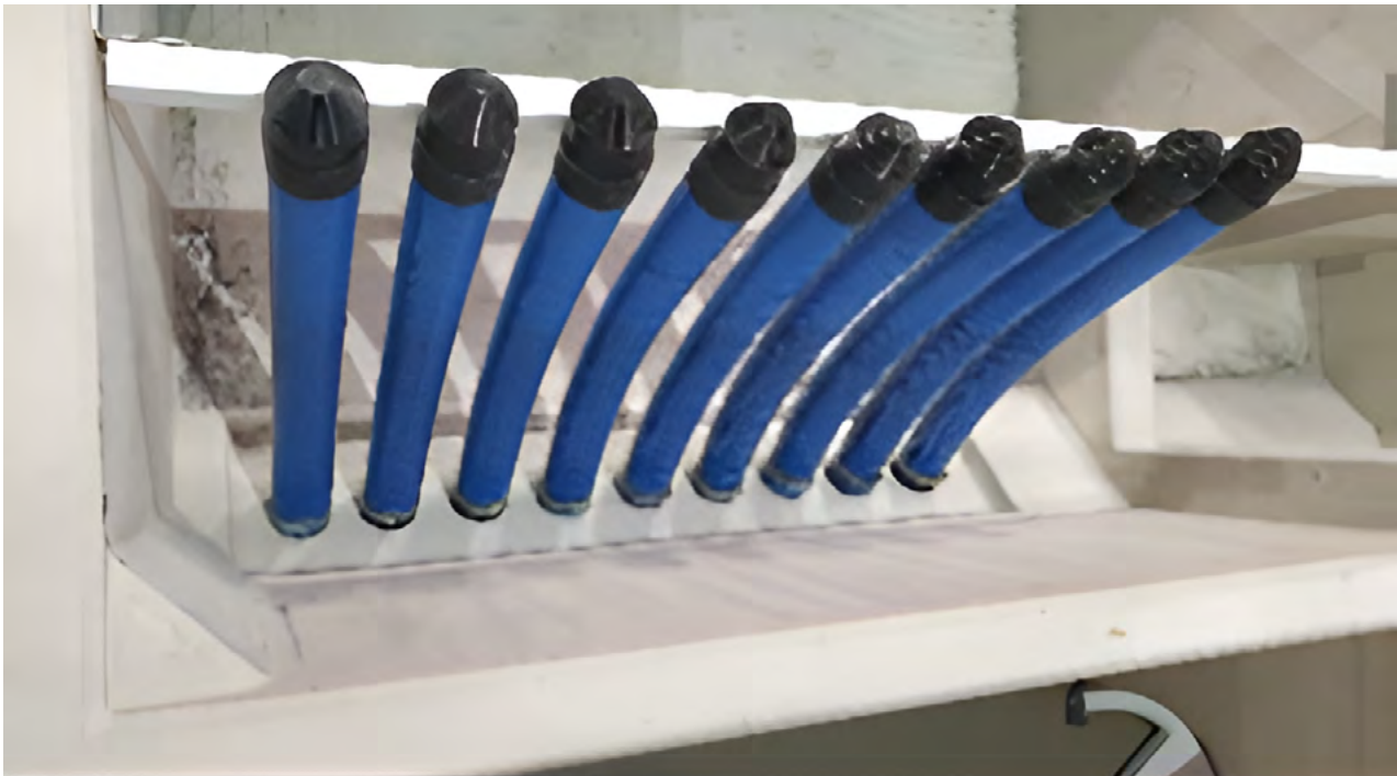
↓ Afbeelding 6. ingestorte slangtules in compactstation.
